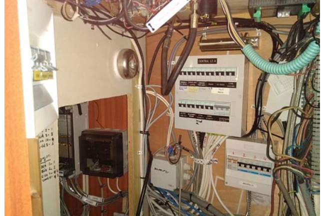
Fig. 8 De ursprungliga säkringscentralerna till höger, den nya uppe till vänster
