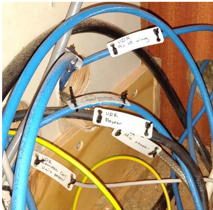
Fig. 11 Uppmärkning av kablar
