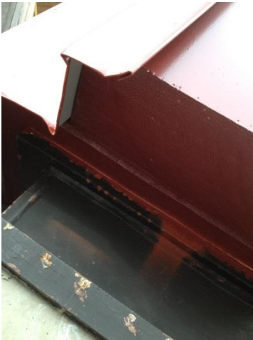
Figur 12. Här är ändytorna väl målade samt täckta av en utskjutande plåt.
