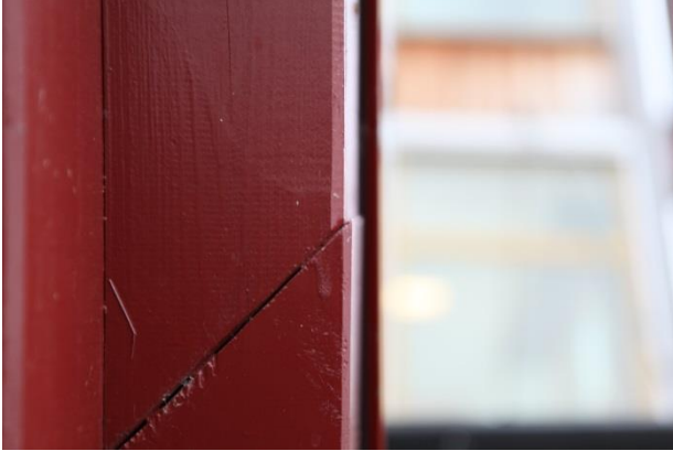
Figur 19. Skarvning av en träkonstruktion som har orsakat fuktfälla med risk för framtida rötskador.
