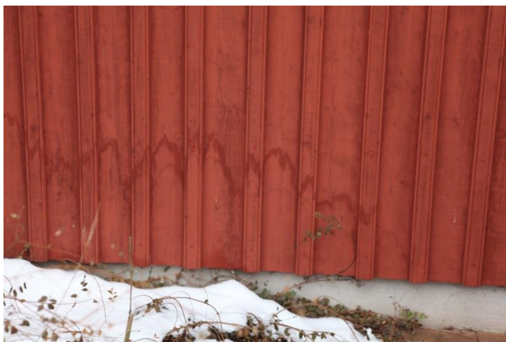
Figur 21. Växtligheten i direkt anslutning till fasaden har orsakat fuktupptag i ändträet.
