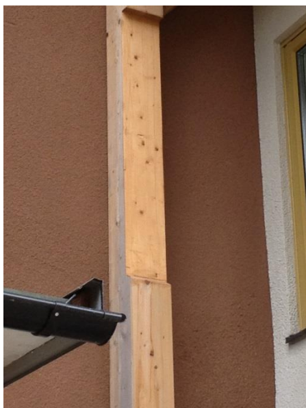
Figur 9. Här har en bärande stolpe av okänd andledning sågats ur och blottar nu ändytan med risk för ökad fuktbelastning.
