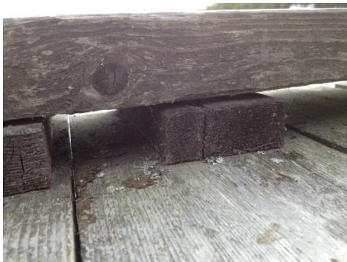
Figur 5. Obehandlat virke ställer extra höga krav på konstruktionen även om mer beständigt virke väljs ut. Virket måste kunna torka ut mellan regnen.
