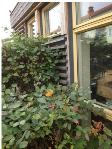
Figur 20. Fasaddetalj med växtlighet i direkt anslutning vilket kan orsaka en förhöjd fuktighet som kan påverka virket negativt.
