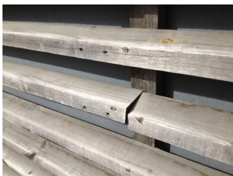
Figur 2. Fasad klädd med mörklövna ribbor av gran, där den mörknära veden orsakat formfel.
