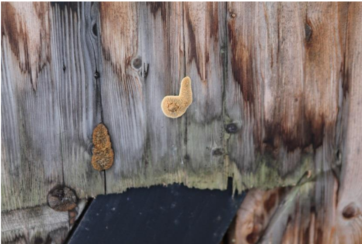
Figur 7. Blottat ändträ har orsakat rötskador.
