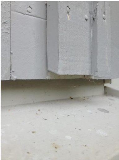
Figur 15. En fasaddetalj med slarvigt utförd ommålning. Ny färg saknas under utskjutande partier. (Vid närmare inspektion visade det sig även sakna ny färg i ändträet.)
