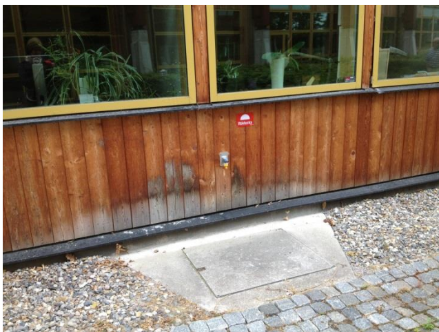
Figur 16. Trots skyddande plåt under fasadpanelen har uppstänkande regnvatten påverkat fasaden. Speciellt på de områden där det funnits en hårdgjord markyta nära fasaden.
