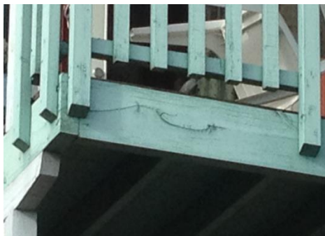
Figur 1. Del av balkong med virke innehållande både tjurved och märgnära ved vilket medför sprickor, men som även ger konstruktionen en lägre hållfasthet.
