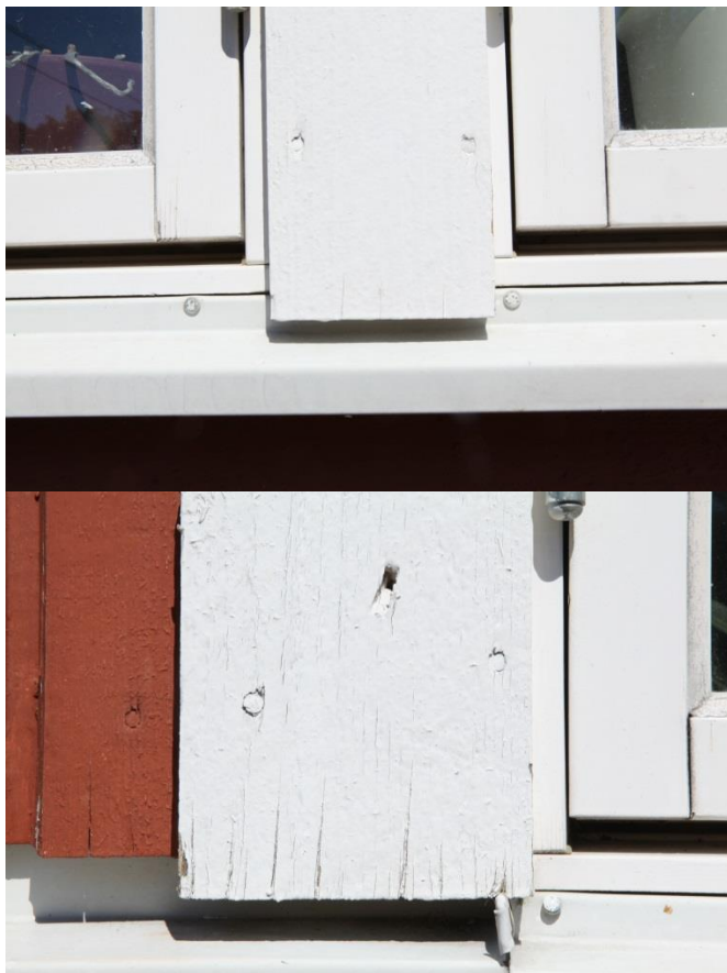
Figur 13. Två fönsterfoder, målade med samma ytbehandling vid samma tidpunkt, men där ändträbehandling missats på ena fodret vilket har orsakat sprickor.
